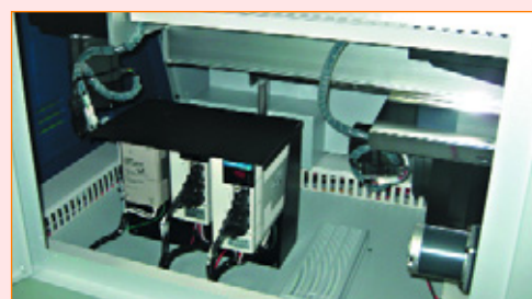
Блоки управления серводвигателями
