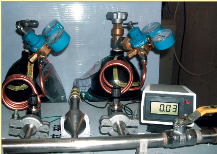
Пример установки сосудов высокого давления в газовую систему среднего давления фирмы Daco
