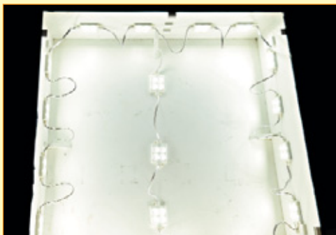
Фото #6. Альтернативный способ монтажа внутренней подсветки.
